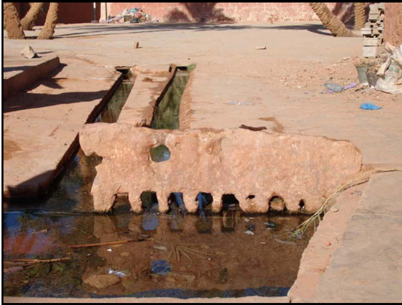
Photo n° 6. Foggara, mal entretenue dans l'oasis de Timimoun
