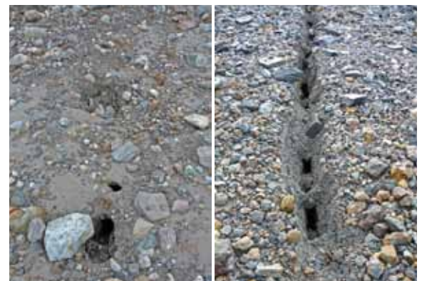
Figure 23 – Le permafrost subit les changements climatiques et réagit immédiatement : des signes visibles affectent directement la géomorphologie. On en trouve des signes dans la moraine de l'Austre Lovénbreen, où apparaissent des entonnoirs (à gauche) et de larges fissures (à droite), (septembre 2008).
